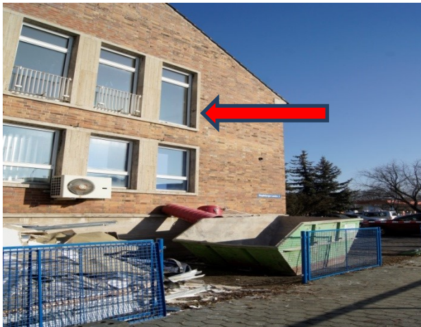
Abbildung 26: Fenster mit abgestürzter Schuttrutsche
