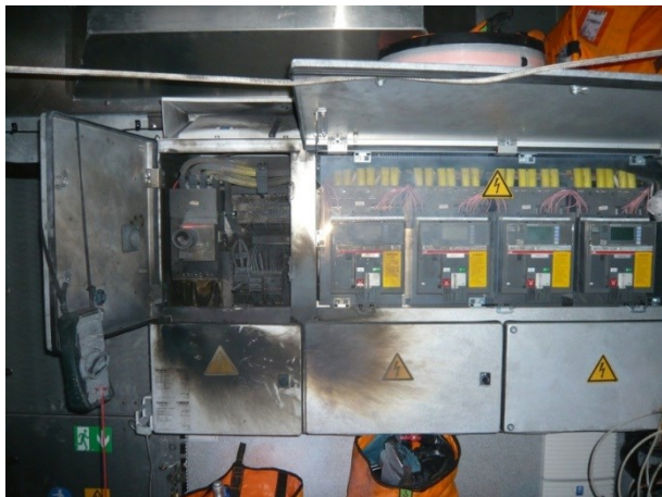
Abbildung 32: Schaltschrank im Maschinenhaus der Windenergieanlage
